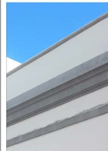
CORNISAS Y MOLDURAS
